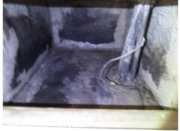
Moisture in plenum
